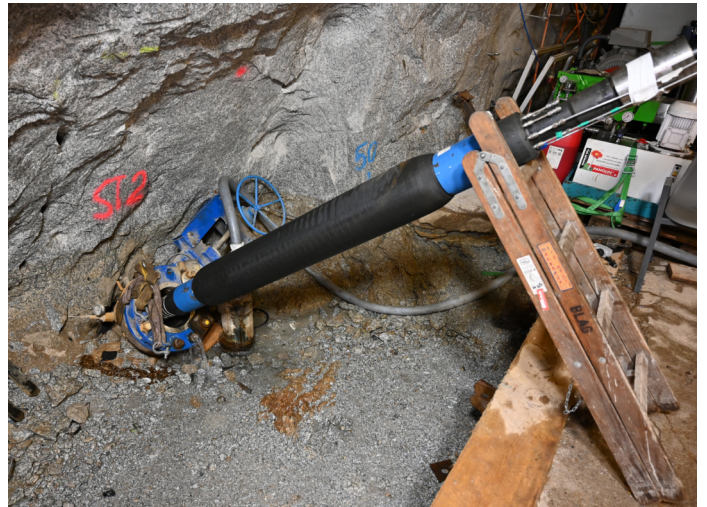
Ein Packer wird ins Bohrloch eingeführt. Ein Packer ist eine aufblasbare Gummimanschette (auf dem Foto sichtbar zwischen den zwei blauen Rohrabschnitten). Damit wird das Bohrloch in einzelne Zonen unterteilt. Packer sind in den Tests Drücken bis 200 bar ausgesetzt. Grafik: Geo-Energie Suisse
