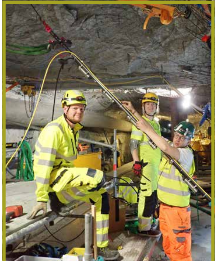
La dottoressa Anne Obermann e il suo team durante l'installazione dei sensori di monitoraggio. © BedrettoLab (foto: Luxwerk.ch).
